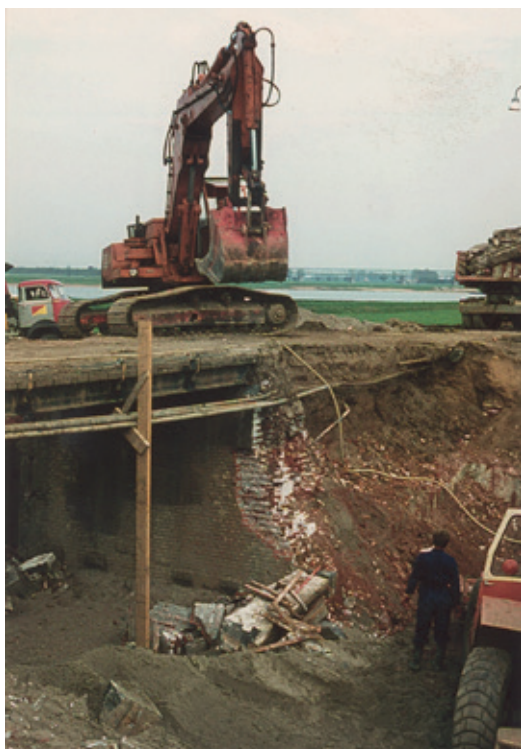
In het kader van de dijkversterking 1978 werd de waaiersluis gesloopt. Regionaal Archief Rivierenland, Tiel
